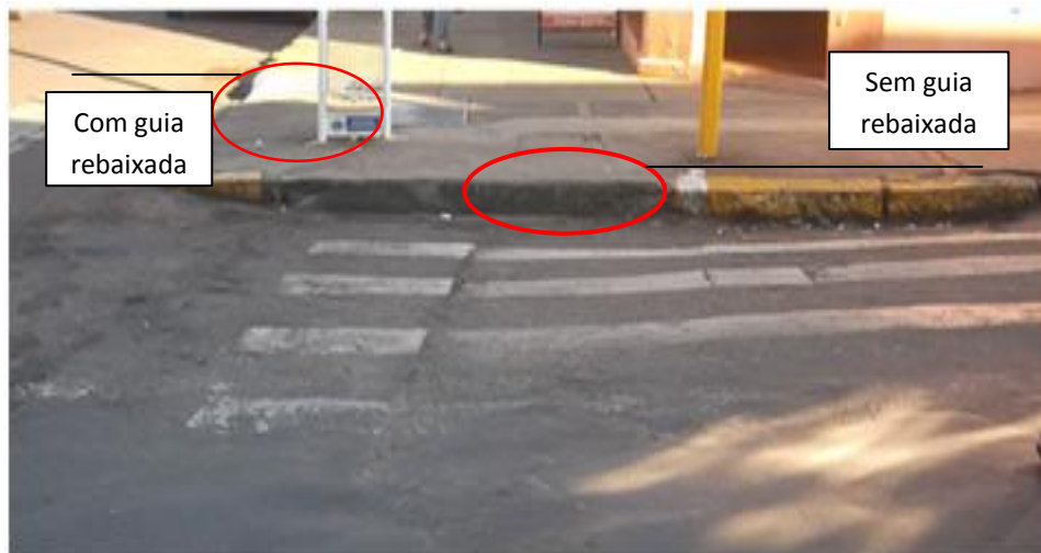
Figura 2 – Calçada sem guia rebaixada para acesso de deficientes
