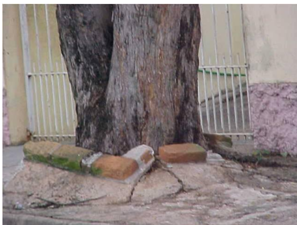
Figura 14. Danos no calçamento por planejamento inadequado no plantio.
