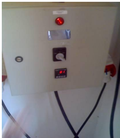
Figura 4 – Painel de comando e controle.
