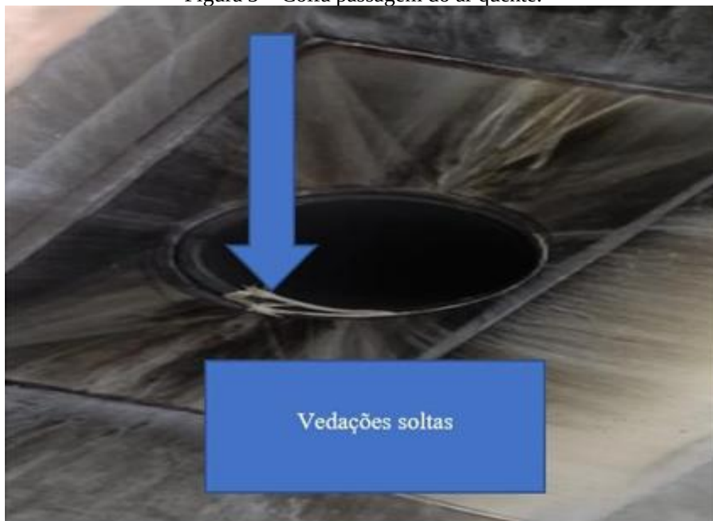
Figura 3 – Coifa passagem do ar quente.
